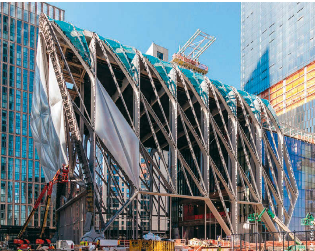
Die fahrbare Stahlkonstruktion besteht aus mehreren aneinandergereihten Jochen. La structure acier mobile se compose de plusieurs traverses alignées.
