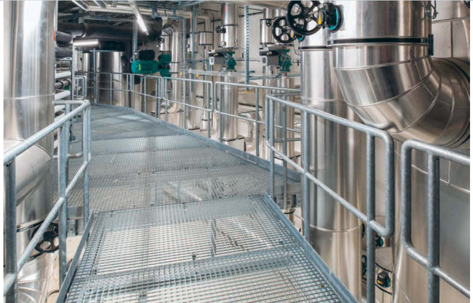
Die Gitterroste mit Maschenweiten von 33 × 33 mm sind für Belastungen bis 500 kg/m 2 ausgelegt.
