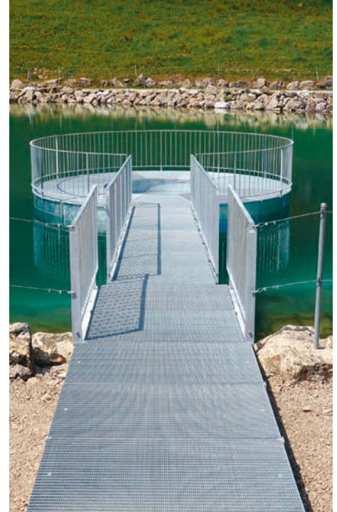
Gut zu erkennen ist der auf Rollen lagernde, einziehbare und somit schmalere Verbindungssteg. Montée sur poulies, la passerelle de liaison est plus étroite pour permettre de la rétracter.
