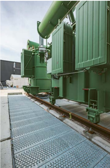
Blechprofilroste des Typs Fire umgeben die Transformatoren.
