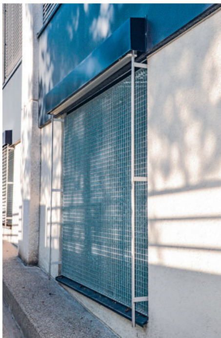
Die Gesamtfläche misst nahezu 5 \text{ m}^2 . Als Stabilisator kam ein Randwinkel zur Anwendung.
