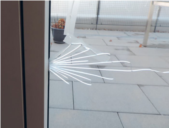
Thermischer Glasbruch bei Isolierglas, Palmsprung seitlich. Bris de vitrage isolant dû à une surcharge thermique, craquelure palmée
