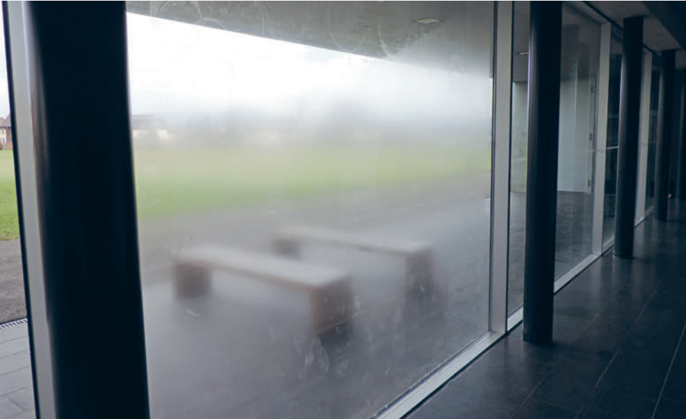
Ungenügende oder fehlende Glasfalzentspannung führte zu Feuchtigkeit, Kondensat und Oberflächenauslaugung im Scheibenzwischenraum eines Isolierglases (blindes Glas).
