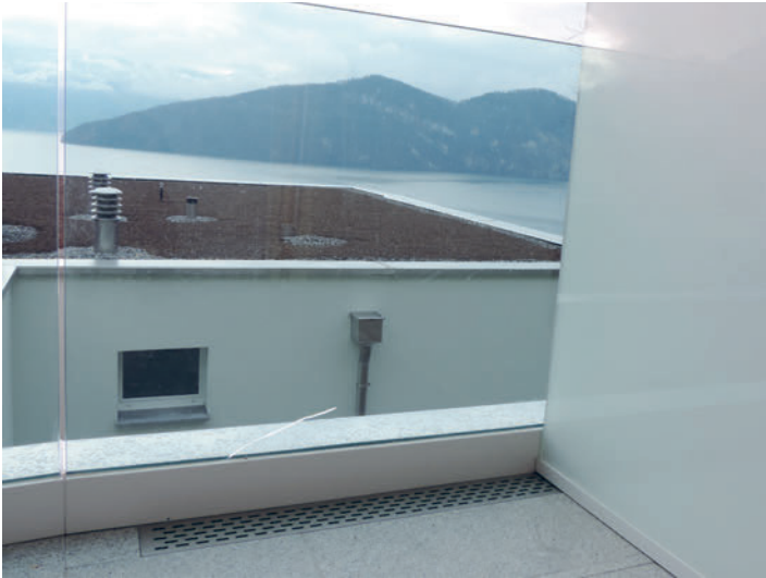
Glasbruch bei unten gehaltenem Ganzglasgeländer im Aussenbereich. Bris de verre des balustrades fixées par le bas à l'extérieur.
