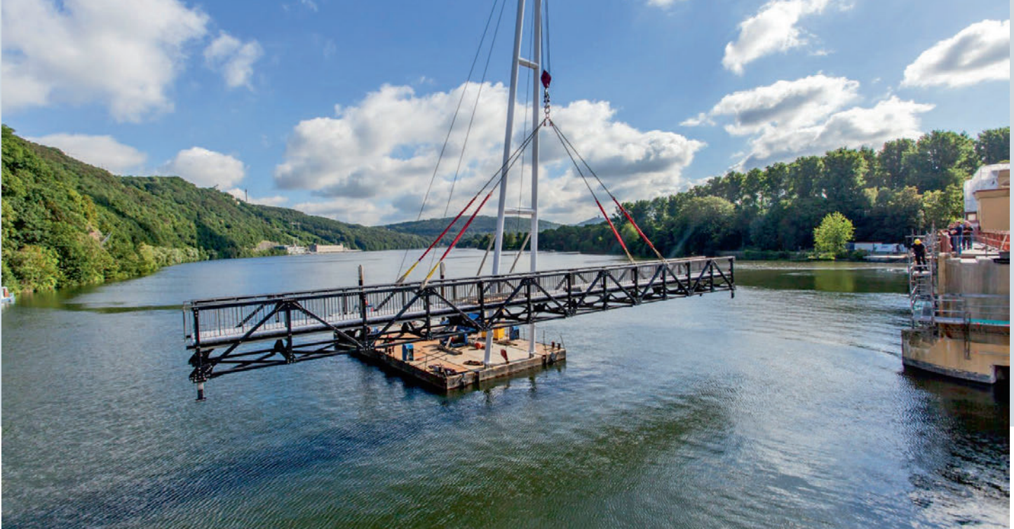
Ein in der Ruhr aufgebauter Schiffskran half, die Brückenteile aus- und wieder einzubauen. Une grue flottante assemblée sur la Ruhr a aidé au démontage et au montage des éléments de la passerelle.
