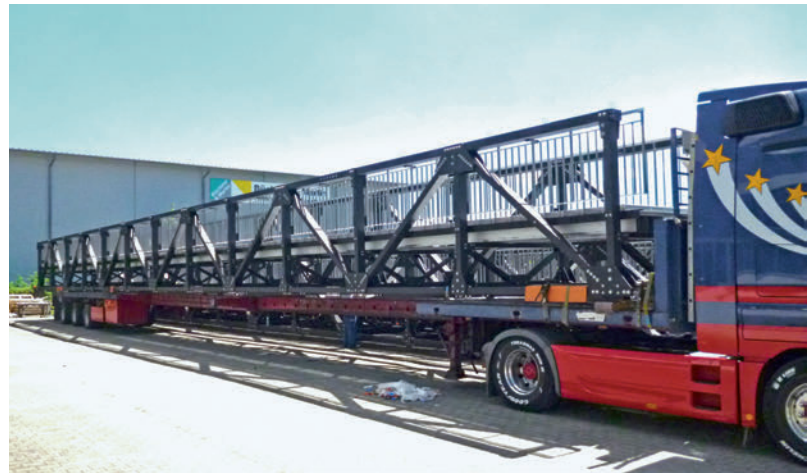
Die vier Stahlbrücken à 30 Meter, die die einzelnen Pfeiler der Stauanlage verbanden, wurden gegen witterungsbeständige Verbindungselemente aus Aluminium ausgetauscht. Les quatre passerelles en acier de 30 m chacune qui reliaient les différents piles du barrage ont été remplacées par des éléments de liaison en aluminium résistants aux intempéries.
