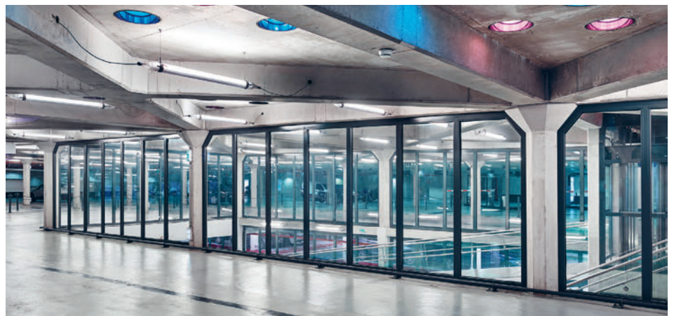
Die raumabtrennenden Brandschutzelemente bieten eine hohe Übersichtlichkeit und somit Sicherheit.
