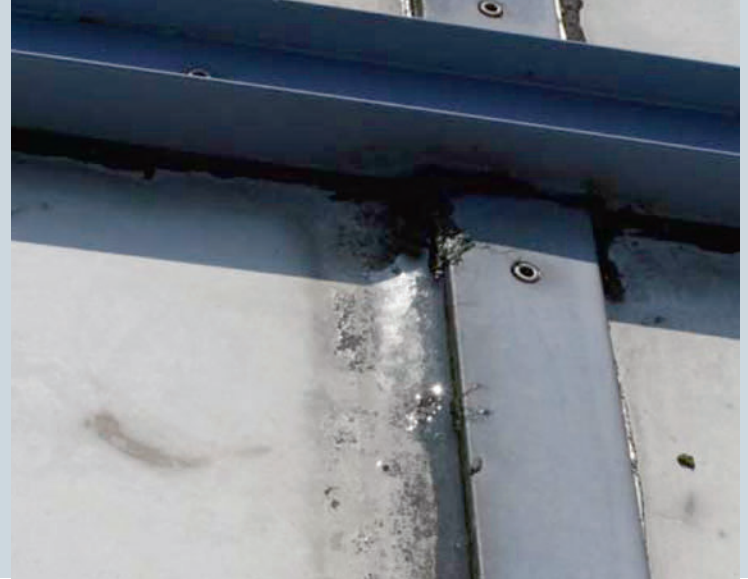
Bild 3: Beispiel von Wasser- und Schmutzansammlungen trotz geringer Bauhöhe der Pressleiste am Riegel.
