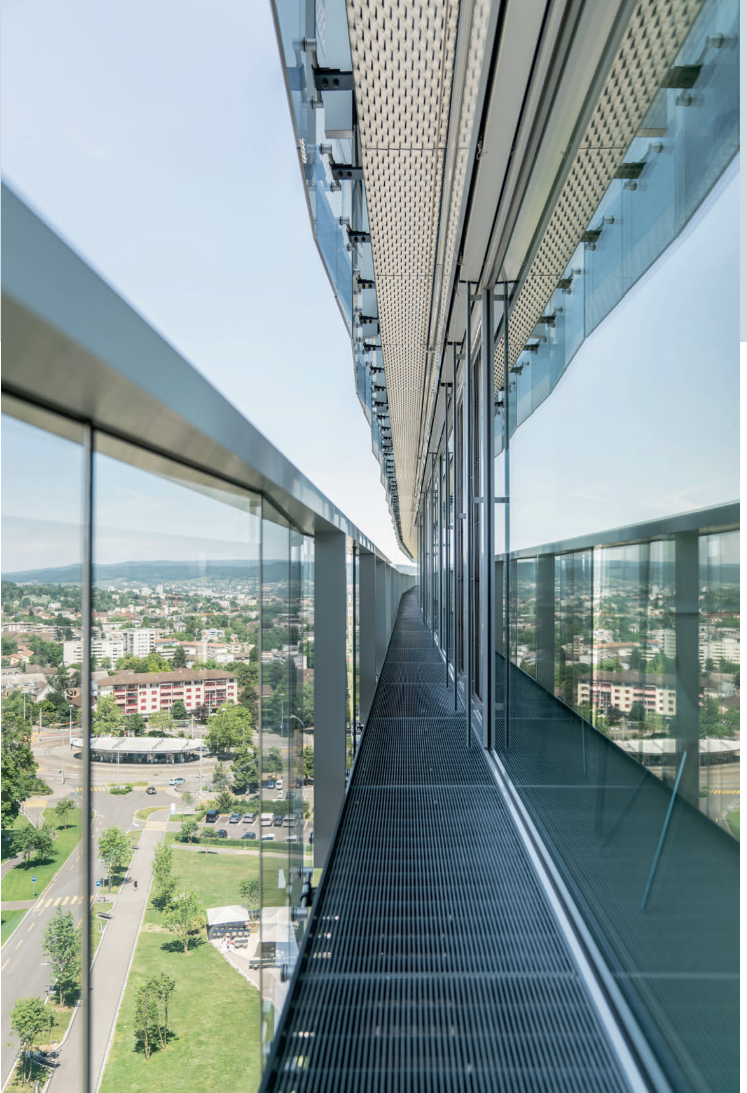
Die Kammroste gewähren eine sichere Umgehung der Fassade auf allen Geschossen.
