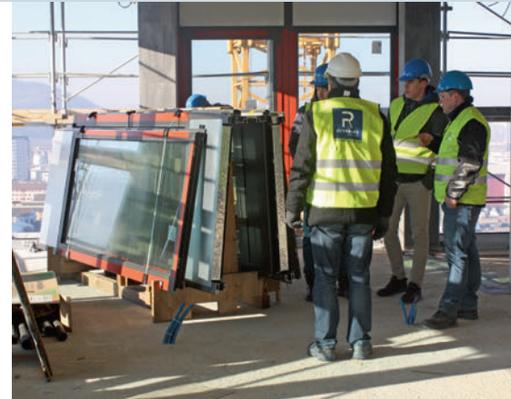
Die verglasten und mit Paneelen bestückten Fassadenelemente sind für den Einbau bereit. Les éléments de façade vitrés et recouverts de panneaux sont prêts à être posés.
