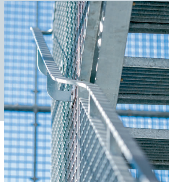
Die Handläufe sind mit Befestigungslaschen an den Gitterrosten befestigt.
