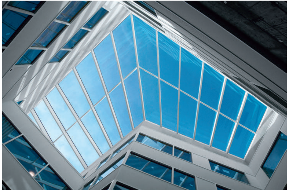
Sicht vom Hofraum: Das Glasdach generiert eine angenehme Lichtdurchflutung. Vue de la cour : le toit en verre génère une diffusion agréable de la lumière.
