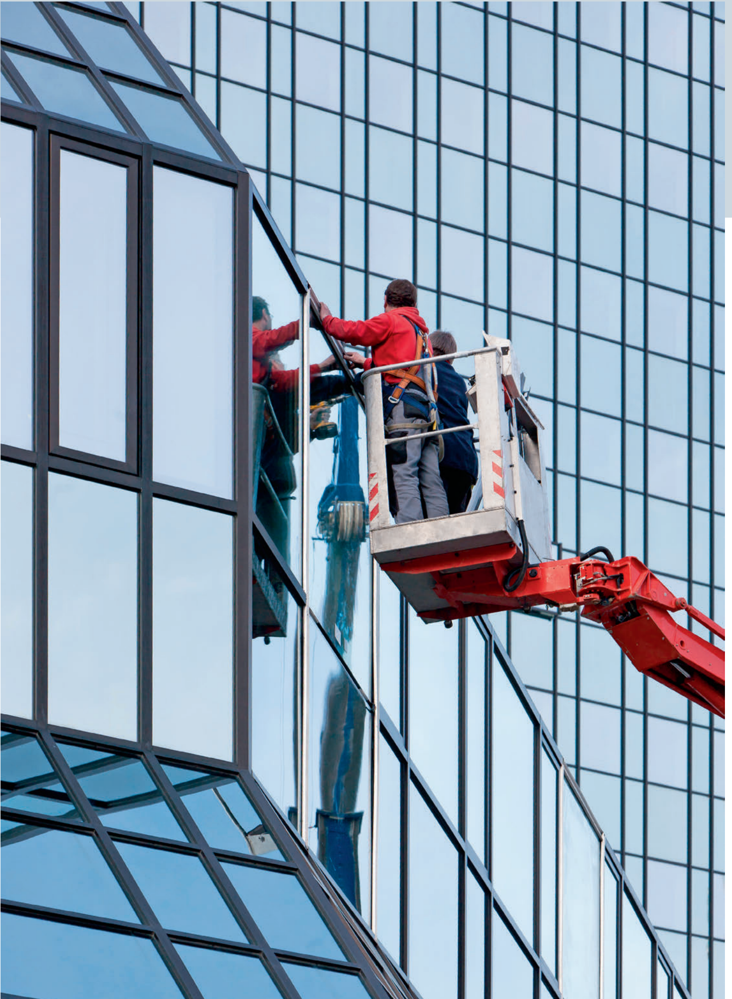
Moderne Glasfassaden lassen sich mit Arbeitsbühnen einfach reinigen. Les plates-formes élévatrices permettent un nettoyage facile des façades vitrées modernes.
