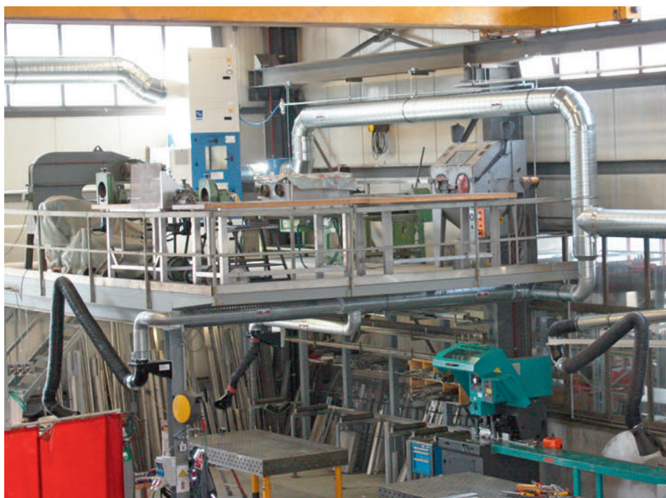
In der Werkhalle ist die Absaug- und Filteranlage auf einem Podest installiert und nimmt so keinen dringend benötigten Platz in der Fertigung ein.
