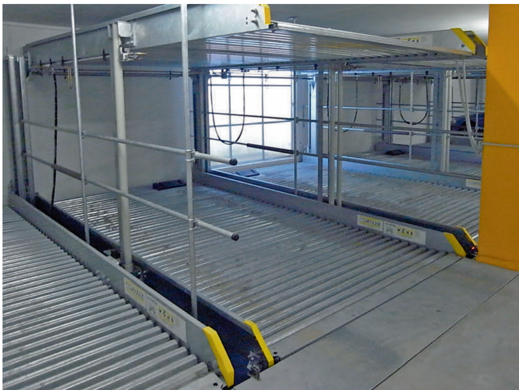
Die Bleche der Autolifte weisen Bildungen von Weissrost auf. Les tôles des monte-voiture présentent des dépôts de rouille blanche.
