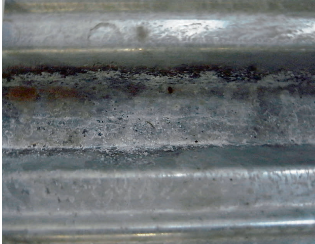
Die Bleche sind grossflächig übersät mit Weissrostbildungen. Les tôles sont en grande partie recouvertes de rouille blanche.
