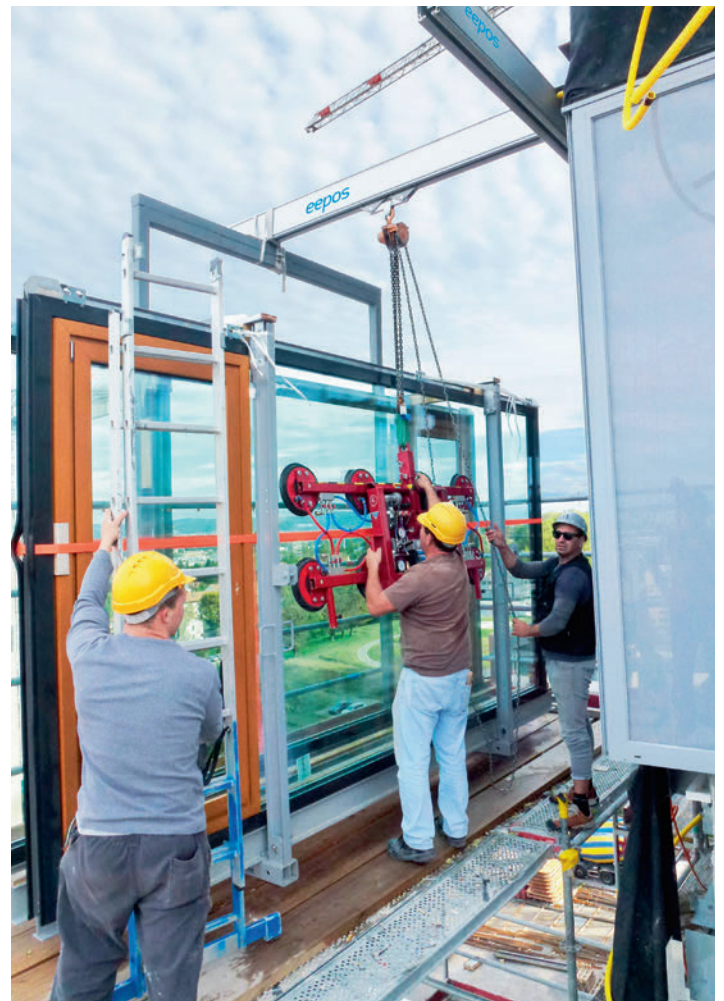
Mithilfe eines Behelfskranwerks gleiten die Fensterelemente vom Transportrahmen zur Gebäudewand und werden an den Fassadenkran übergeben. A l'aide d'une structure de manutention auxiliaire, les éléments de fenêtres glissent depuis le châssis de transport vers le mur du bâtiment, où ils sont transférés sur le rail de façade.
