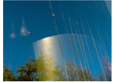
Abbildung 6: Ansicht der Schichtverletzungen auf Sonnenschutzglas (Praxisbeispiel 3). Illustration 6 : Vue des dommages sur le verre de protection solaire (exemple pratique 3).
