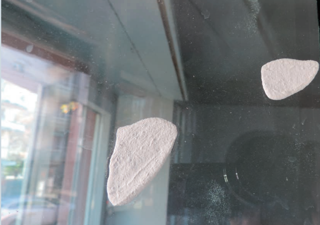
Abbildung 1 Spritzer von Umbauarbeiten auf dem Glas.
