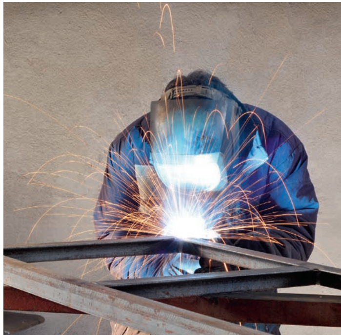
Die einzuführende europäische Norm EN 1090 regelt die Ausführung von Stahl- und Aluminiumtragwerken.
