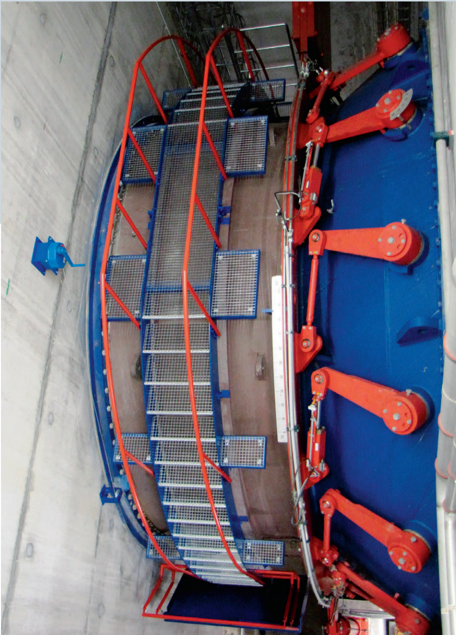
Die Rohrturbine wird in regelmässigen Abständen gewartet. Die neue Rundtreppe mit dem beweglichen Podest erleichtert die Zugänglichkeit enorm. Le groupe-bulbe fait l'objet de maintenances régulières. Le nouvel escalier rond avec plate-forme mobile facilite grandement l'accès.
