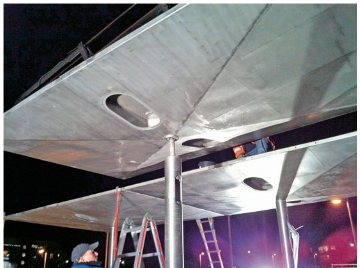
Nachtmontage. Gut zu erkennen ist der Entwässerungstutzen, der in die Säule geführt wird. Montage de nuit. Bien reconnaissable, le raccord d'évacuation des eaux est intégré à la colonne.
