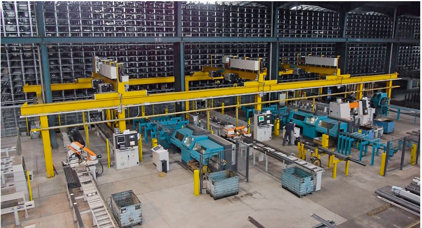
Gesamtansicht Anarbeitung mit sechs integrierten Sägemaschinen.
