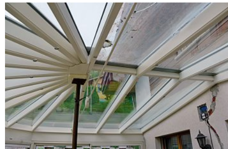
Der mangelhafte Wintergarten: Mangelnde Steifigkeit erforderte zusätzliche Abstützungen, damit das Glas aufgelegt werden konnte. La véranda défectueuse : le manque de solidité a nécessité des appuis supplémentaires pour pouvoir fixer les vitres.
