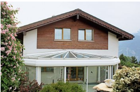
Der mangelhafte Wintergarten: Dieser musste komplett ersetzt werden. Eine Nachbesserung war aufgrund der massiven Mängel auszuschliessen. La véranda défectueuse a dû être entièrement remplacée. Les nombreux manquements rendaient toute amélioration impossible.
