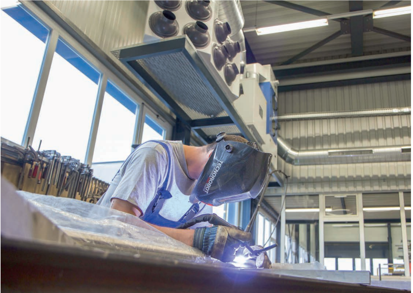
Auch der Schweisssrauch wird bestens abgezogen. Même les fumées de soudage sont parfaitement aspirées.
