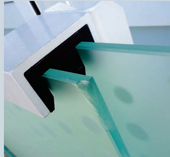
Von Bruchgläsern beschädigte untere Gläser. Vitres inférieures endommagées par la chute de verre.
