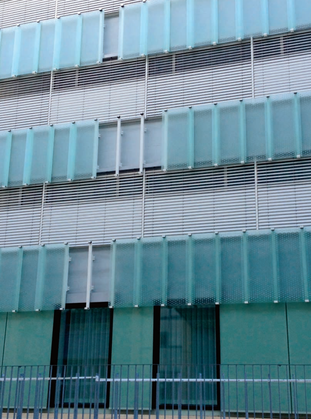
Fassadenansicht: gut zu erkennen, die Lücken infolge der zerbrochenen Gläser. Vue de la façade : on distingue aisément les espaces laissés par les vitres cassées.
