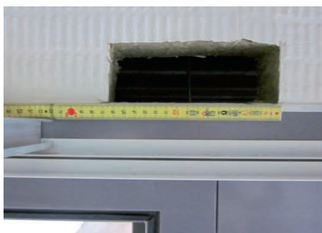
Bild 2 - Schlosseitig fehlende Befestigung gegen die Decke.
