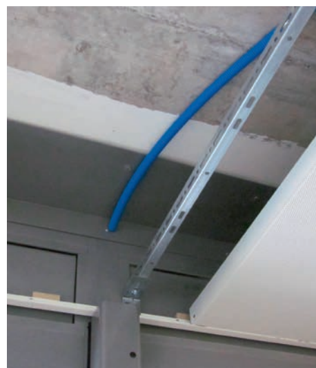
Bild 3 - Aufgeschraubtes Verstärkungsrohr ohne Befestigung in den Massivbau.
