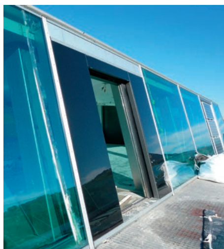
Eine weitere Spezialität im Attika-Geschoss: schräg stehende, automatisierte Schiebetüre. Flügel thermisch getrennt und mit Blech beplankt. Antrieb Produkt Tormax.
