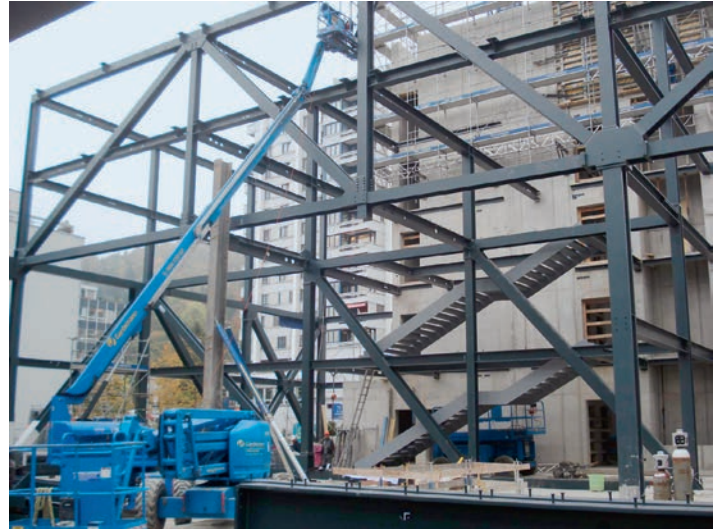
Das Stahlgerippe ist aufgerichtet und für die Montage der Deckenelemente bereit. L'ossature en acier est montée et prête à recevoir les éléments de plafond.
