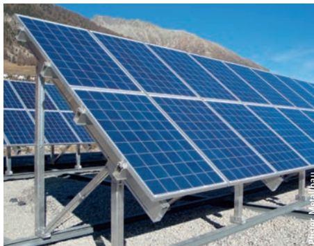
Photovoltaik-Anlage auf Gebäudedach mit Schüco-Montagesystem MSE 210.
