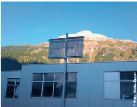
Vertikal gestellte Vakuumröhren-Kollektoren für die Aufbereitung von Warmwasser. Schneebeschlag ist ausgeschlossen und die Bestrahlung am Morgen und am Abend von beiden Seiten möglich.
