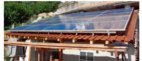
Photovoltaikanlage auf Gebäudedach mit Schüco-Montagesystem MSE 210.
