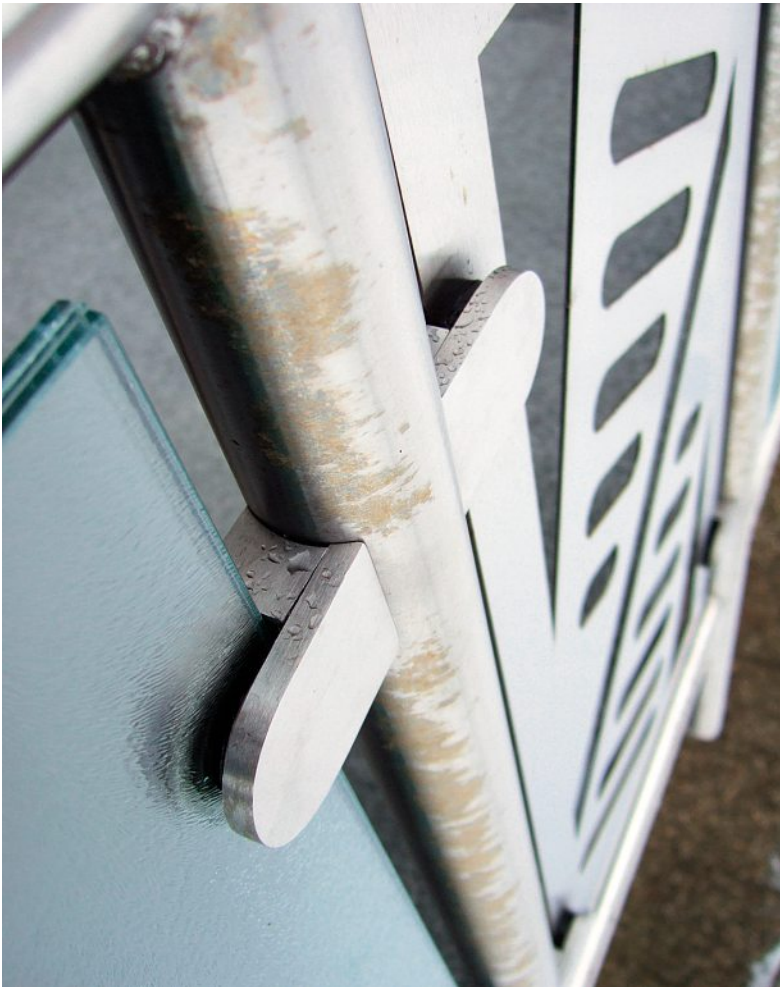
So sieht das Schadensbild aus, das durch die Bundesanstalt für Materialforschung als «Verfleckungen» beschrieben wurde. Es unterscheidet sich deutlich von den Korrosionserscheinungen am beanstandeten Geländer.
