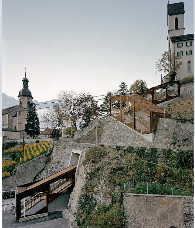
Esch Sintzel Architekten führen den neuen Weg weitgehend ausserhalb des Berges. Le bureau d'architectes Esch Sintzel a imaginé un tracé le plus extérieur possible.
