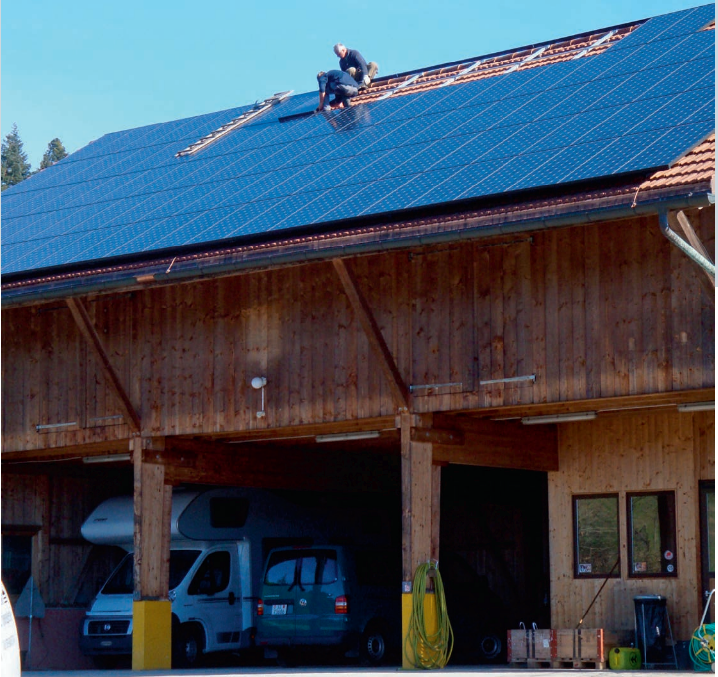
Montage einer Solaranlage ohne vorgeschriebenen Kollektivschutz.
