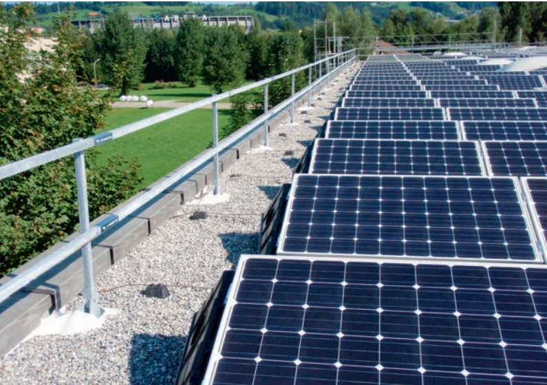
Kollektivschutz für den Unterhalt: herunterklappbares Geländer. Cellules solaires encrassées.
