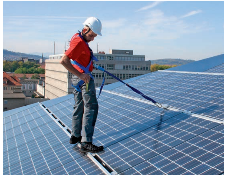
Moderne Photovoltaikanlage mit integrierter Absturzicherung für Reinigung und Instandhaltung. Installation photovoltaïque moderne avec dispositif antichute intégré pour le nettoyage et la maintenance.
