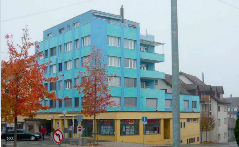
Das Gebäude vor der Sanierung. Heizenergiebedarf 140 kWh/m 2 a. Bâtiment avant la rénovation. Besoins énergétiques pour le chauffage : 140 kWh/m 2 a.
