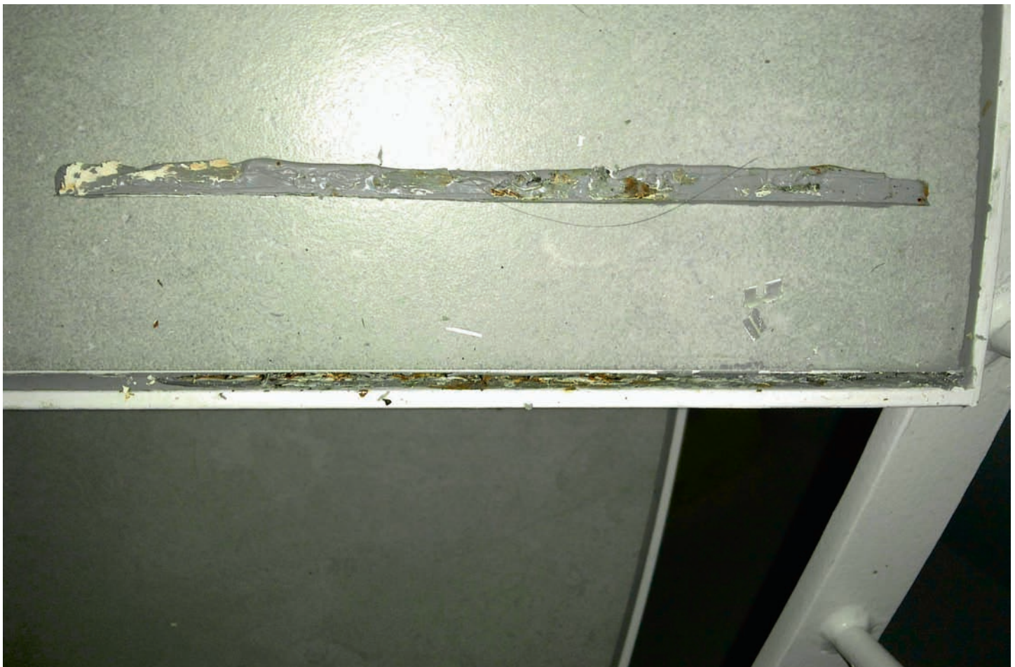
Blick auf die Treppenstufe mit herausgeschnittener Silikonfuge. Dahinter wirkte die Feuchtigkeit. Marche avec joint en silicone retiré. Derrière, l'humidité a fait son œuvre.
