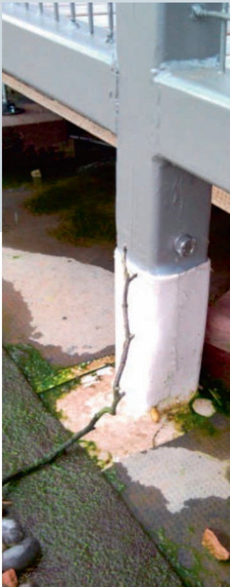
Mangelhaft: Dachhaut-Durchdringung mit Abdichtung auf dem wiederum durchbohrten Gängelkopf.
