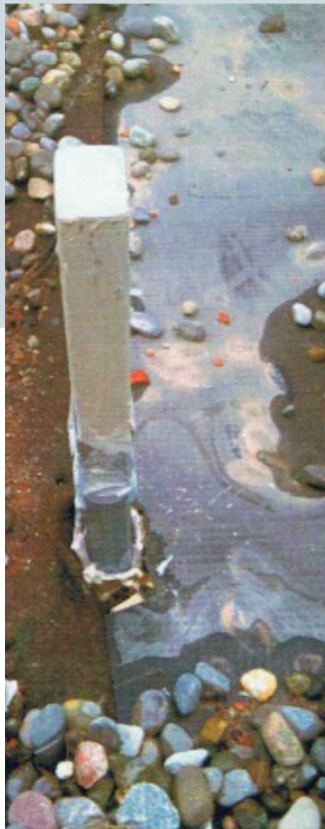
Konsolenpfosten aus Hohlprofil mit mangelhafter Anschlussabdichtung.
