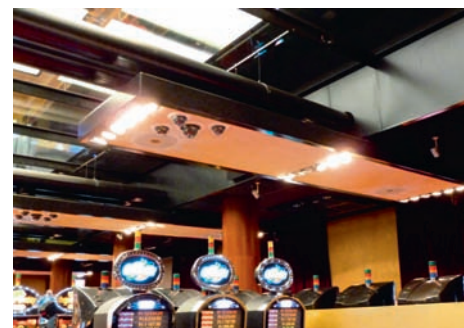
Das Deckenelement mit integrierten Kameras, Beleuchtungen und Lüftung scheint zu schweben. L'élément de plafond avec caméra, éclairage et ventilation intégrés semble flotter.
