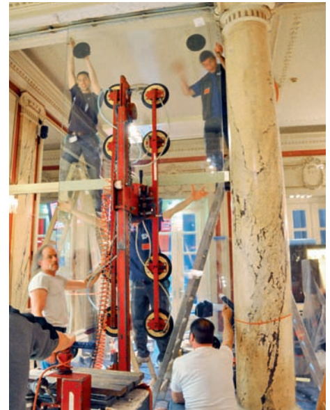
Der Einsatz der über 350 Kg schweren Gläser (VSG 21-4 klar), erfolgte mit einem Raupenfahrzeug mit Saugvorrichtung. L'installation des verres de plus de 350 kg (verre de sécurité feuilleté 21-4 clair) est effectuée à l'aide d'un chariot sur chenilles et dispositif de ventouses.
