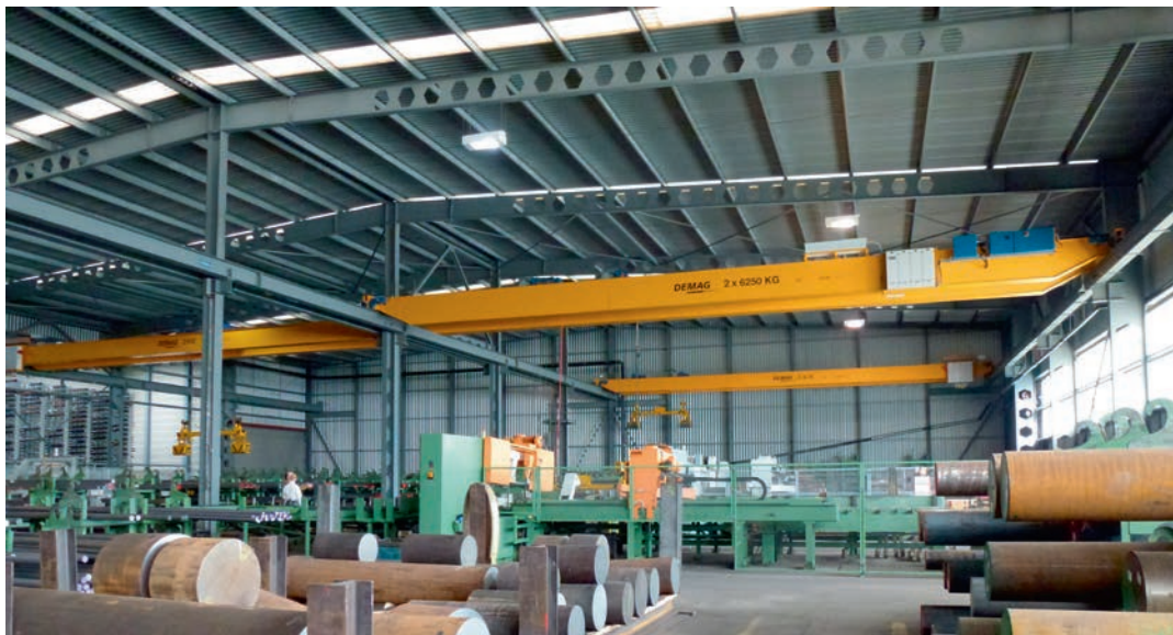
Die Kranbahnen von ca. 100 Metern erstrecken sich über die gesamte Hallenlänge. Mit der Demag-Technologie überwachen sich die Systeme gegenseitig.
