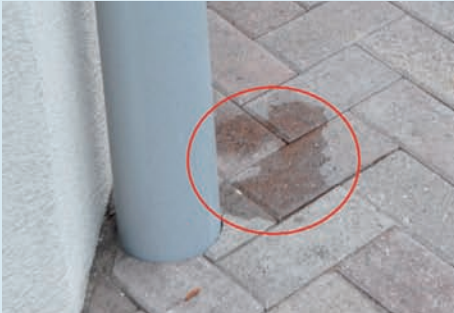
BILD 2: Tropfenbildung neben Ablaufrohr. PHOTO 2: Formation de gouttes près du tuyau d'évacuation
