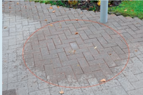
BILD 3: Spritzwasser durch Tropfenbildung unter dem Glasdach. PHOTO 3: Projections d'eau par la formation de gouttes sous le toit vitré.
