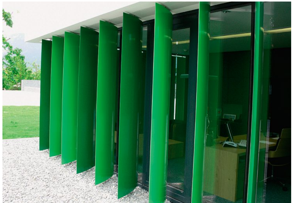
Die Aluminiumlamellen stehen unten auf einem Drehlager und sind oben - in einem U-Profil - gehalten und werden über ein Schneckengetriebe und Gestänge angetrieben.
