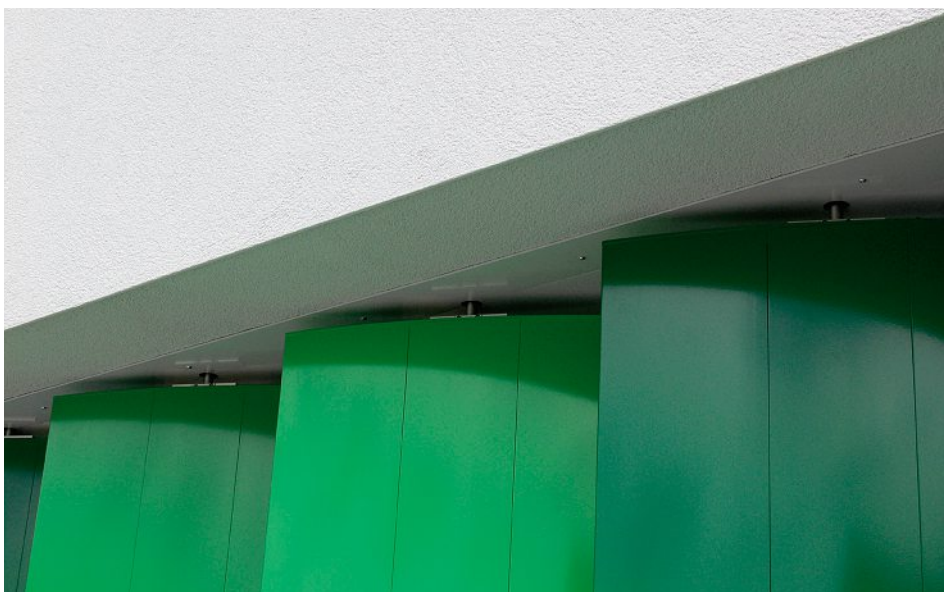
Die Ansteuerung der Sonnenschutzlamellen erfolgt in perfekter Abstimmung mit der Gebäudeautomation. Durch ihren intelligenten Einsatz soll der Energiebedarf des Gemeindezentrums um bis zu 30 Prozent pro Jahr reduziert werden.
