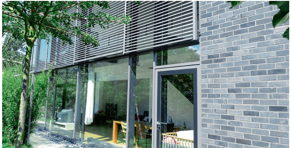
Heftige Knackgeräusche im Abstand von wenigen Minuten wurden vom Auftraggeber dieser Fassade bemängelt. Le client s'est plaint de craquements importants au niveau de la façade à quelques minutes d'intervalle.
