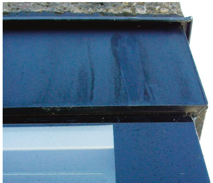
III. 6 : Dépôts de calcaire, brûlures sur façade en béton
