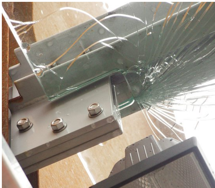
III. 12 : Bris de verre en raison d'une encoche après contact verre - métal
