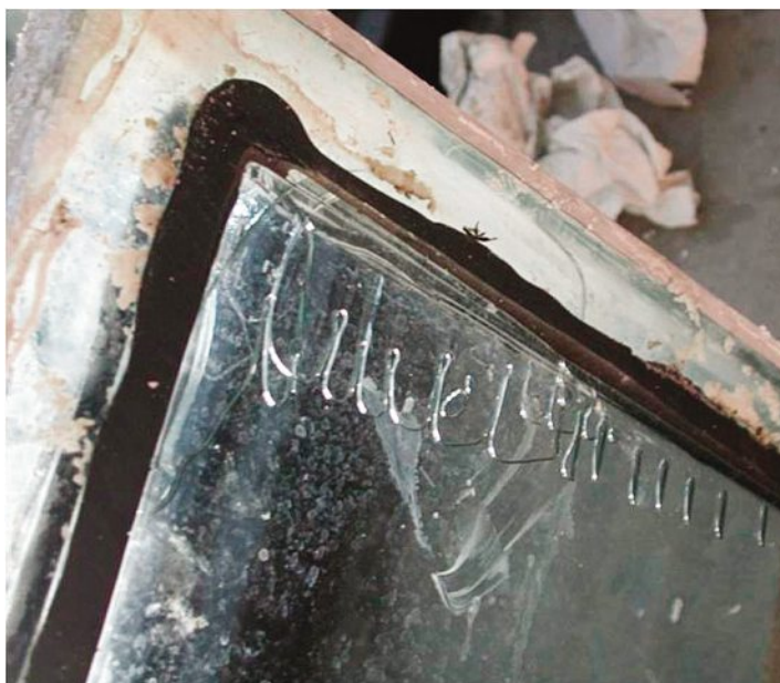
III. 11 : Dommages dû à l'humidité sur un vitrage coupe-feu
