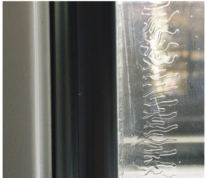
III. 5 : Délamination (décollement) de verre de sécurité feuilleté
