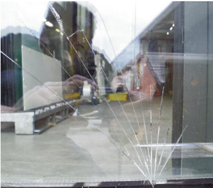
III. 2 : Bris de verre en raison d'une tension thermique
