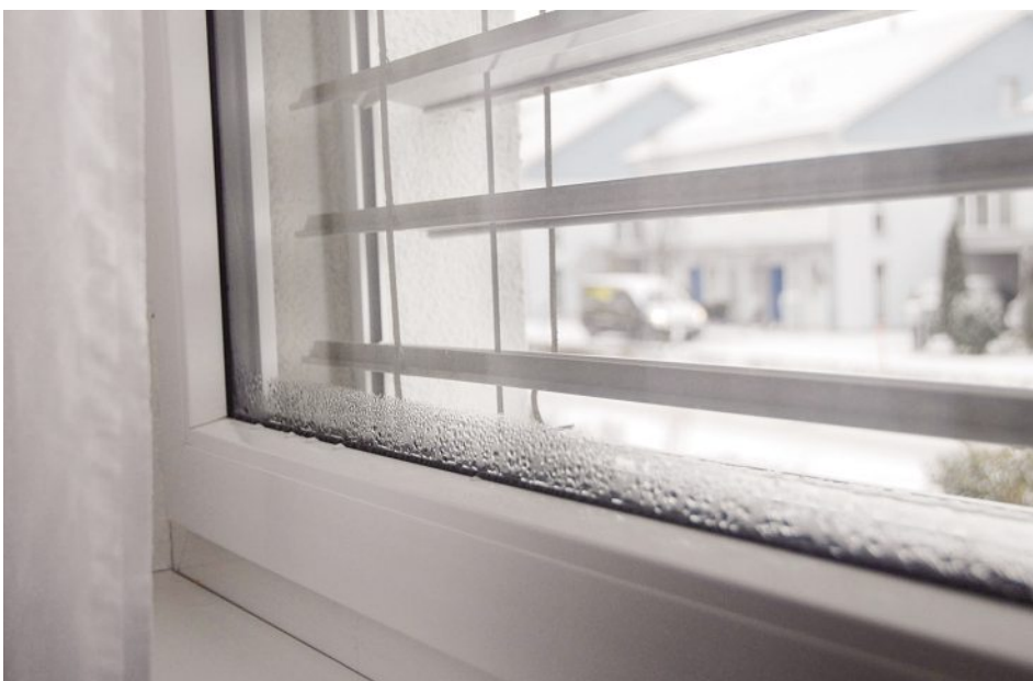
Ill. 9 : Eau de condensation dans la zone du bord de verre
