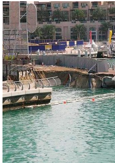
Dammbbruch und Flutung der 20 Meter tiefen Baugrube im Jahr 2007.
