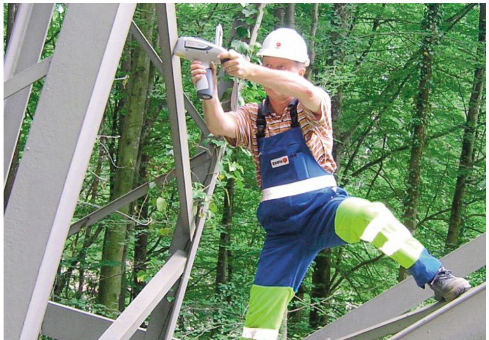
Schwermetallanalyse des Korrosionsschutzanstriches eines Hochspannungsmasten. Peinture anticorrosion d'un pylône haute tension : analyse des métaux lourds.
