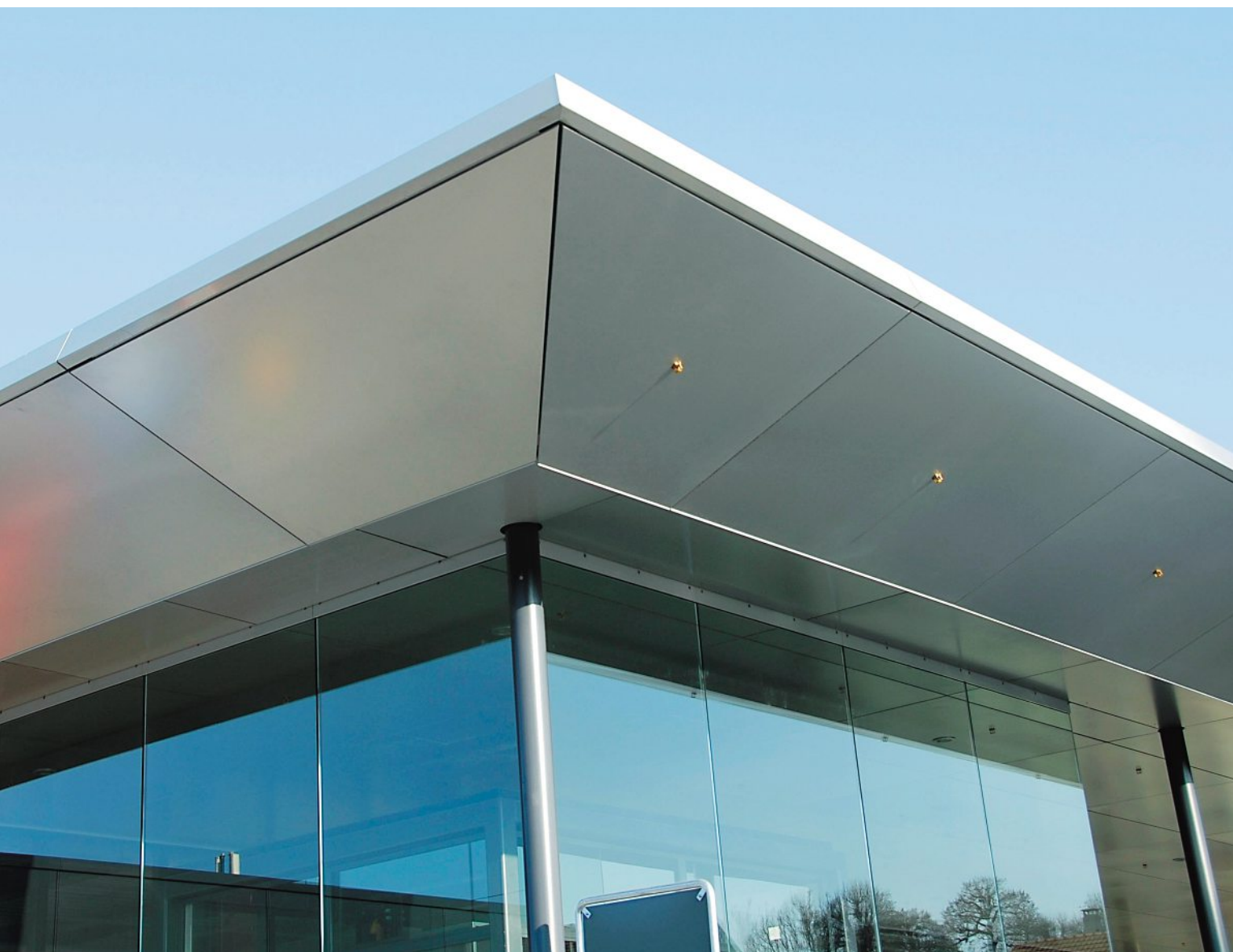
Überdachung mit Vordach fertig verkleidet. Unten eine unisolierte Wetterschutzverglasung mit Silikon-Stoffugen. Toiture avec avant-toit avec revêtement. Dessous, un vitrage non isolé de protection contre les intempéries avec joints en silicone.
