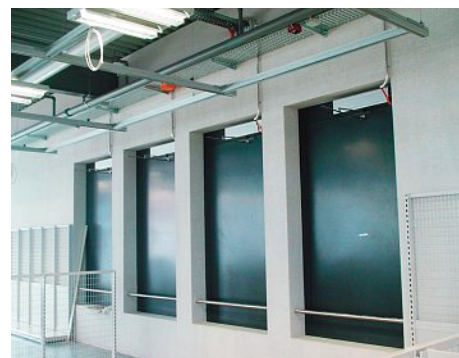
Die 4 Stück RWA-Zuluftflügel mit total 12 m 2 Lüftungsquerschnitt, 90°nach aussen öffnend, mit Drehflügelantrieb und innenliegender Absturz-sicherung. Objektbezogene Einzelzulassung war erforderlich.
