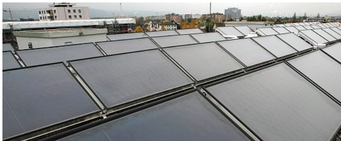
Immer mehr Mehrfamilienhaus-Besitzerinnen und -Besitzer setzen auf die Kraft der Sonne und installieren grosse Anlagen.
