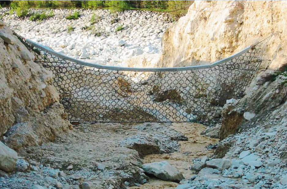
Abb. 2/2 a Installierte Versuchssperre 2006 im leeren und gefüllten Zustand, am Illgraben.
