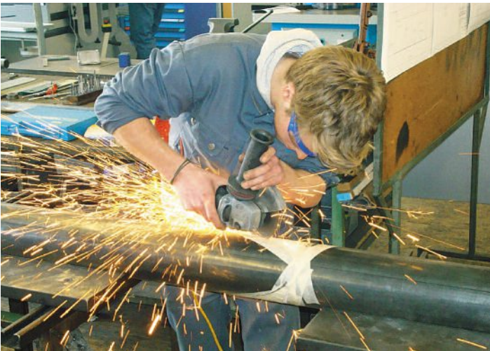
Das Zuschneiden des Rohrjoches konnte nicht mit der Kreissäge realisiert werden.
